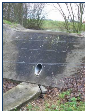
Débit de fuite du bassin de régulation (Ø200 mm)
